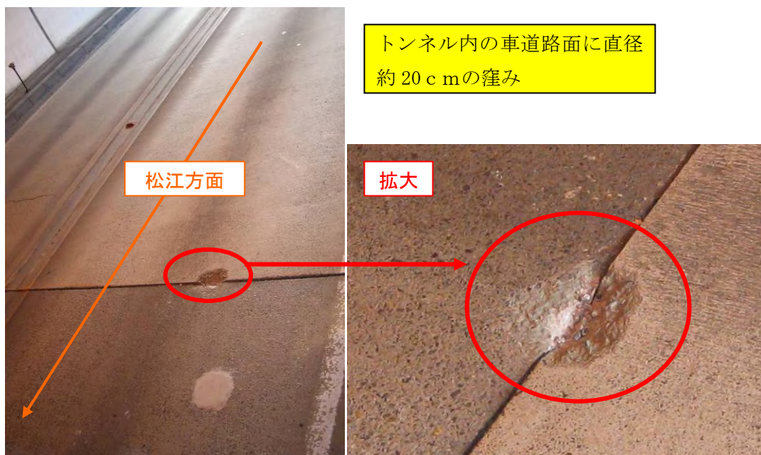
(車道に窪み／国道9号・相生第一トンネル)
