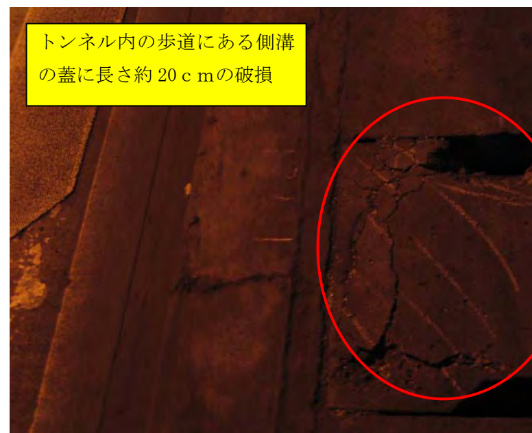
(歩道の側溝蓋に破損／国道191号・田万川トンネル)
