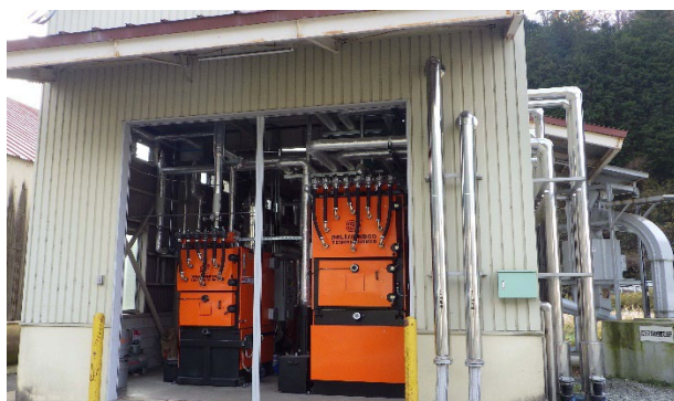
木質バイオマスによる地域熱供給システム
