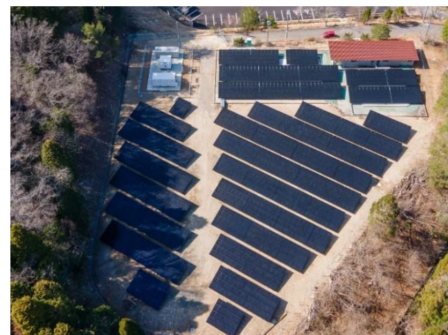
▲小学校プール跡地に設置した発電設備と蓄電池
