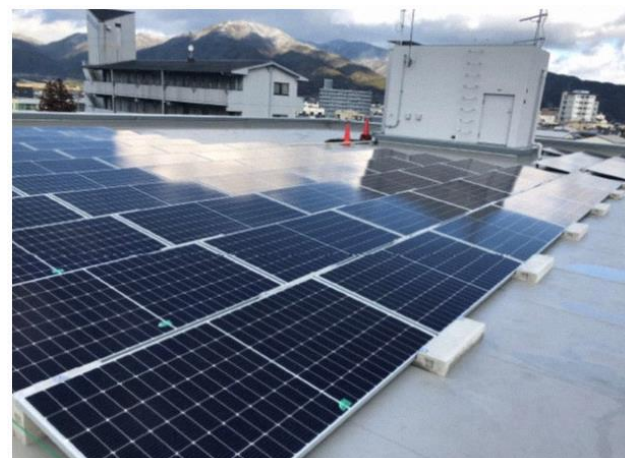
上下水道部庁舎:自家消費型太陽光発電設備
