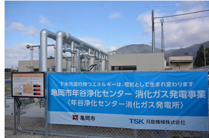
年谷浄化センター消化ガス発電所
