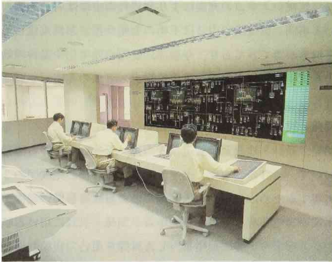
電力会社の電力システム集中監視・制御
