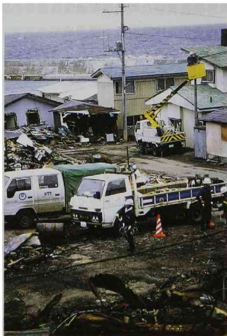
災害復旧（奥尻島）
