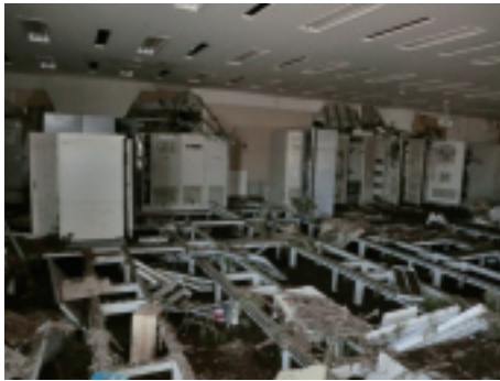
図表 1-8 海底ケーブル陸揚局 (Jih 仙台局舎)
