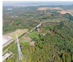
＜鉄塔倒壊全景＞
