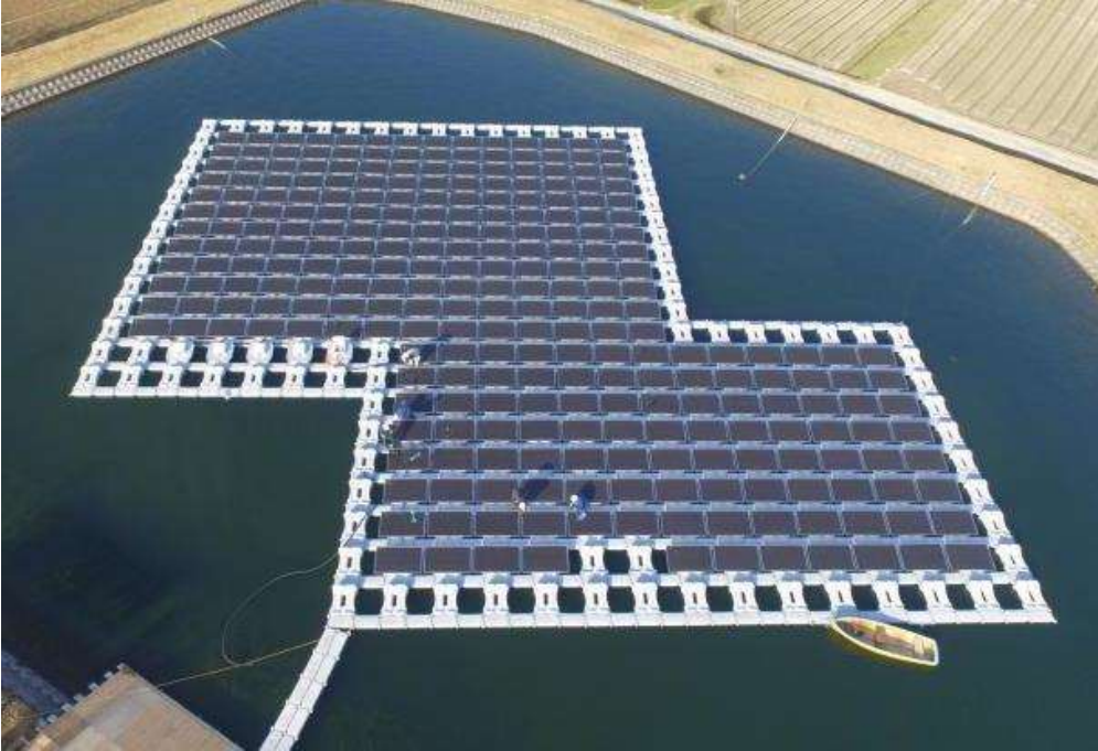
塔下新池ため池ソーラー発電所
