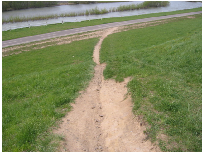
(苗穂3丁目付近) 上から見た損傷
