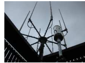
基地局の構造物によって雨量測定が影響を受けない位置に雨量計を取り付け。(特許出願中)
