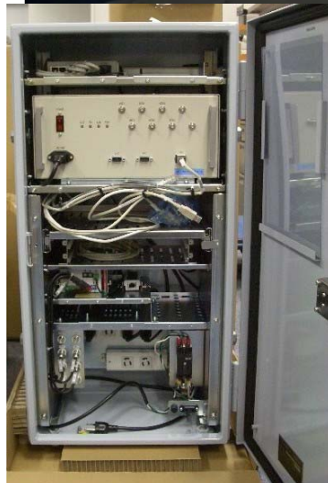
路側無線機装置
