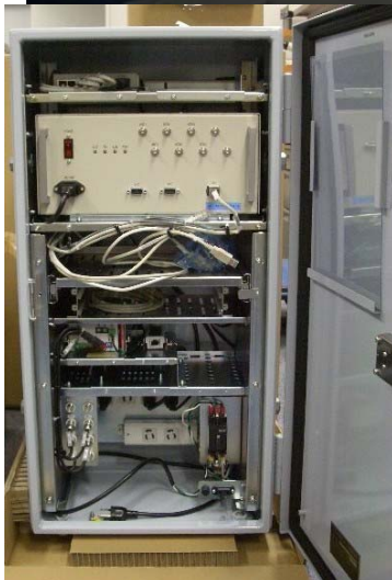
路側無線機装置
