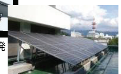
太陽電池パネル
