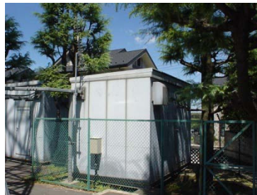
TOKYO FM 八王子中継局 局舎設備
