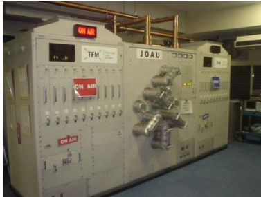
TOKYO FM 親局 送信機 10kW 現用/予備
