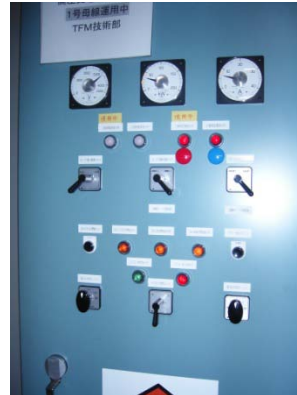
TOKYO FM 親局 電源設備 2系統設備
