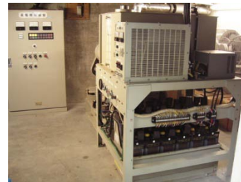
TOKYO FM 青梅中継局 自家発電機設備
