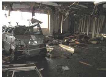
建物は残っているものが 損傷が激しい通信ビル内部
