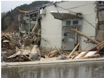
津波の影響による被害で 建物に甚大な被害
