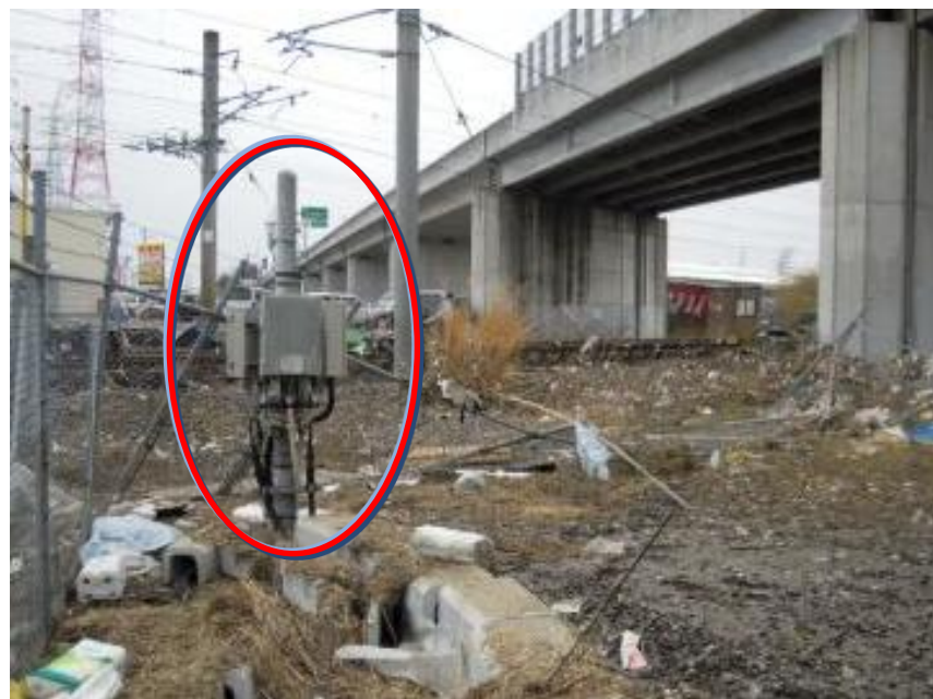
津波の被害のあった基地局 (多賀城市)
