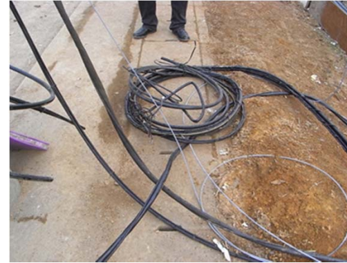
切断された幹線 光ケーブル
