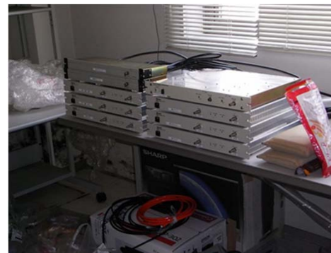
病院事務所内の 仮設ヘッドエンド
