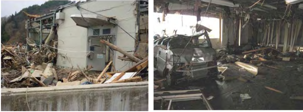
(大規模災害等緊急事態における通信確保の在り方に関する検討会 第1回ネットワークインフラワーキンググループ NTT 東日本説明資料より) 図 1-5 津波の被害を受けた通信ビル
