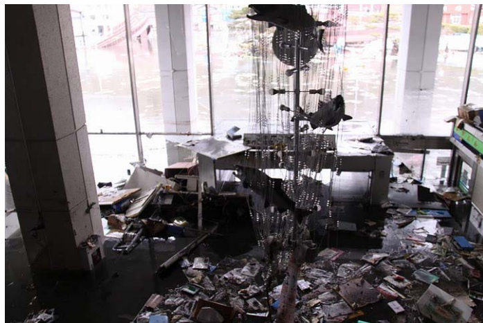
（津波が引いた後の本庁舎 1 階の様子。庁舎外ではまだ水が完全に引いていない。）
