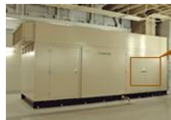
非常用発電機
