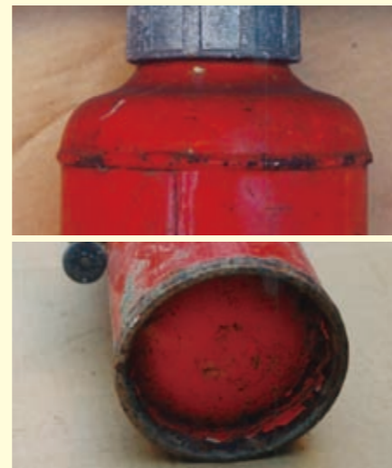
長い間放置され腐食の進んだ消火器
