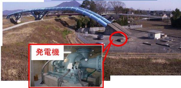
小貝川小水力発電施設
