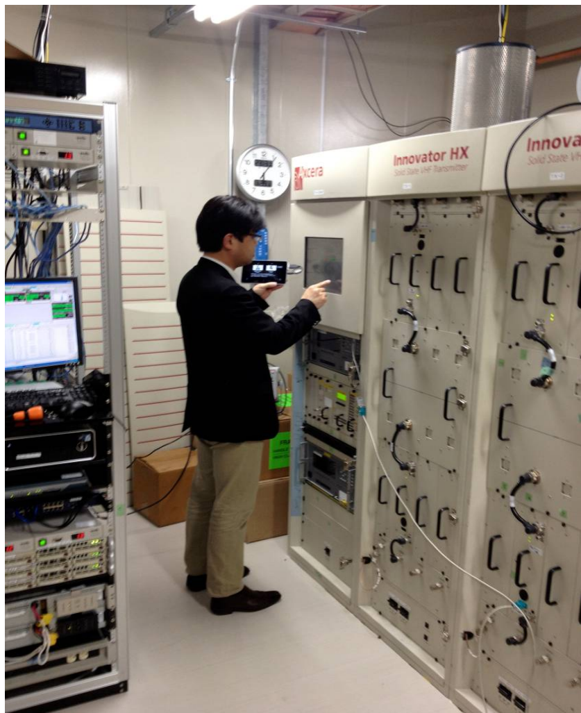
福岡タワー局 (3kw、ERP6.2kw)
