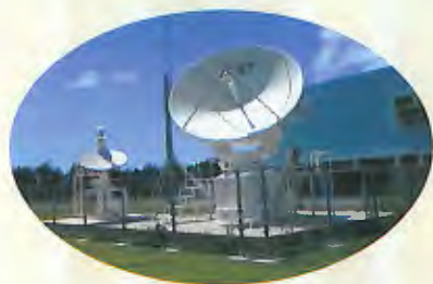
準天頂衛星「みちびき」 地上局アンテナ
