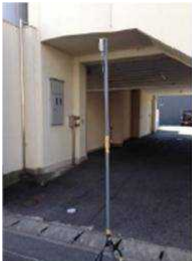
中継局 2 (移動前) の設置状態
