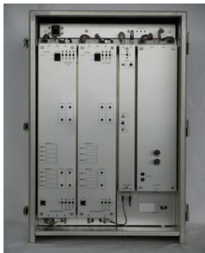
可搬型緊急用BSヘッドエンド
