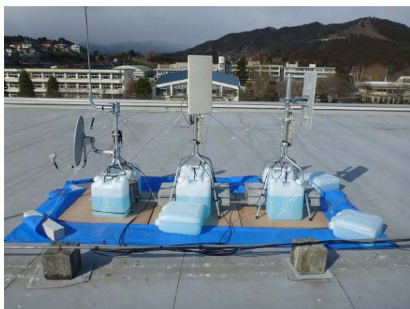
送受信アンテナ設備
