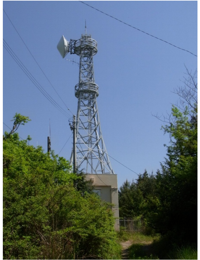
防災行政無線アンテナ2
