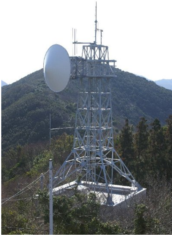
防災行政無線アンテナ1
