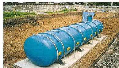
耐震性貯水槽※
