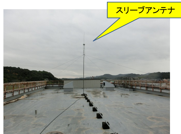
市役所屋上送信アンテナ
