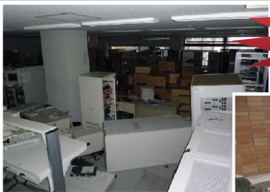
地震によるサーバ室の破壊
