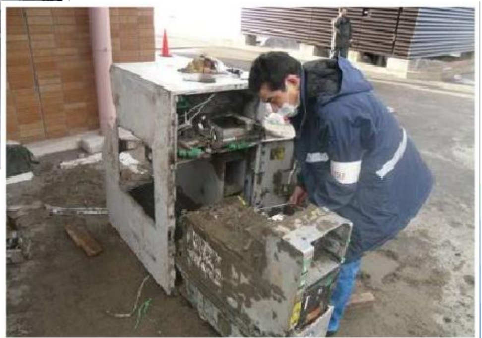
津波によるサーバの浸水 カルテ流失による個人情報の漏洩
