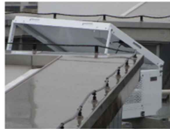
太陽電池システム
