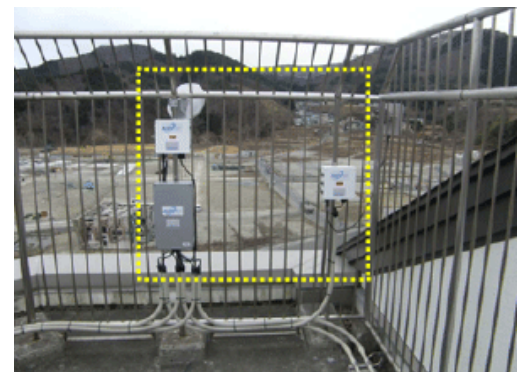
【地域医療センターに設置された無線機器】
