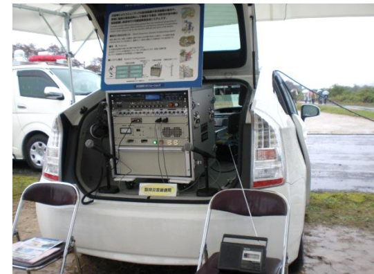
＝ 臨時災害放送局設備(FM放送) ＝ 協力(株)日立国際八木ソリューションズ 中部支店
