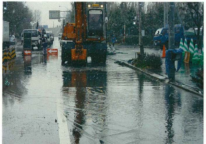
漏水事故の様子
