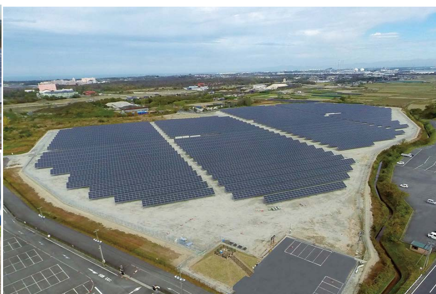
北新潟太陽光発電所
