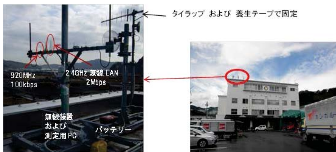
図 付 3- 1 大槌町役場屋上に設置した送信機の様子
