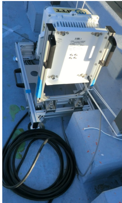
(b) 親局屋外装置設置状況
