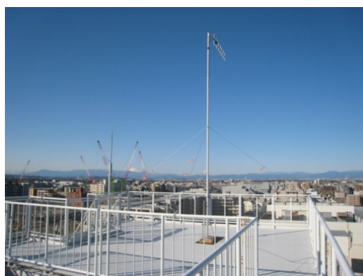
親局(三鷹)空中線設置状況
