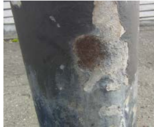
鋼管柱の軽い腐食
