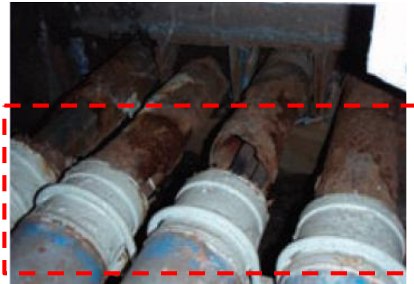
補修前 管路が錆びて欠けている
