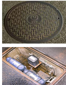
マンホール・ハンドホール
