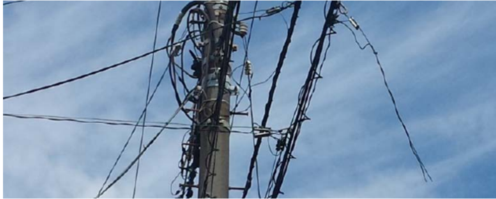
引込線の垂れ下がり
