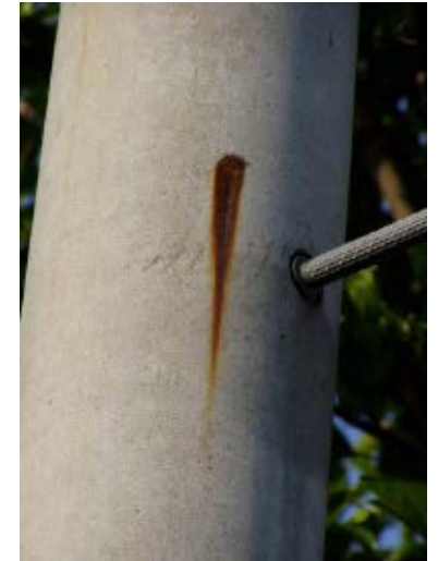
塩害による赤錆しみ出し
