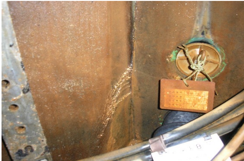
マンホール内部の亀裂
