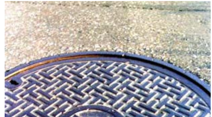
鉄蓋と受枠の段差
