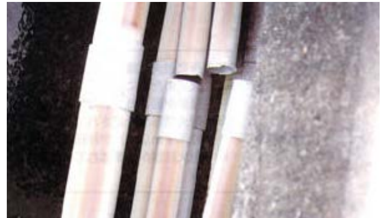
橋梁添架管路の抜け
