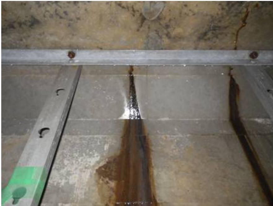
補修前 漏水が発生 （コンクリートの中酸化）
