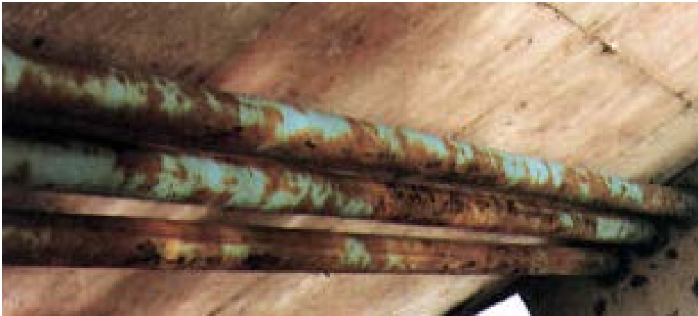
橋梁添架管路の塗膜劣化
