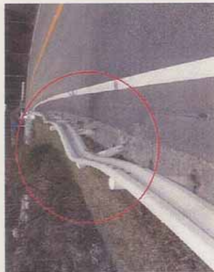
【防護柵の損傷】
