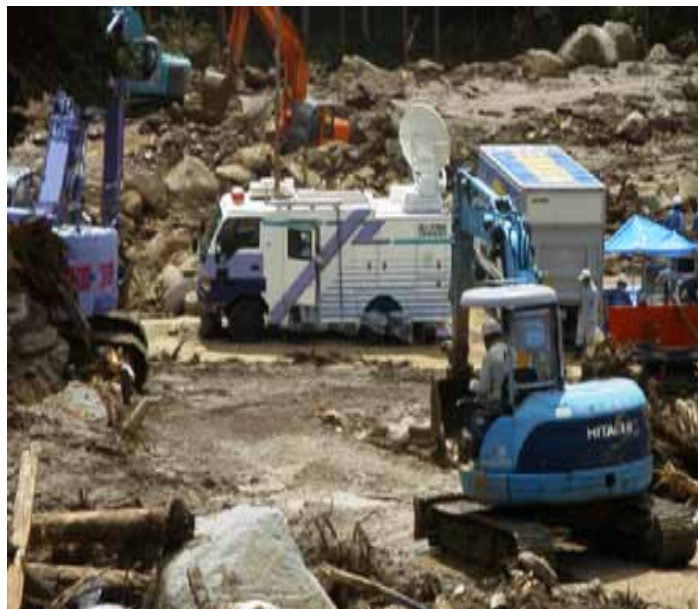
土石流現場衛星通信車
