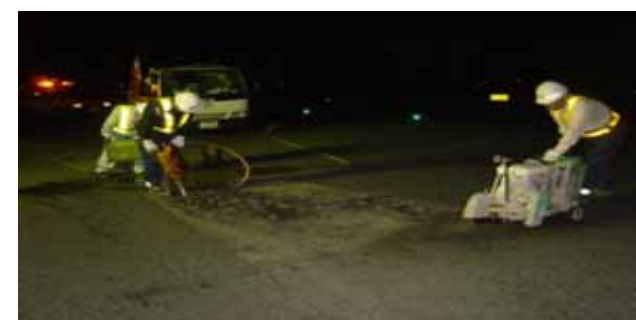
(緊急補修:舗装の破損等により、航空機の運航に支障が生じないように、緊急に補修を実施)
