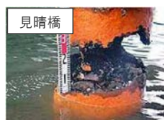
鋼鉄製の支柱の腐食
