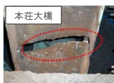
トラス橋の斜材の破断
