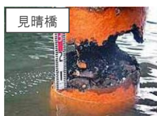
鋼鉄製の支柱の腐食
