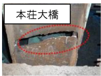
トラス橋の斜材の破断
