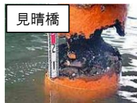
鋼鉄製の支柱の腐食
