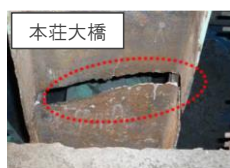
トラス橋の斜材の破断
