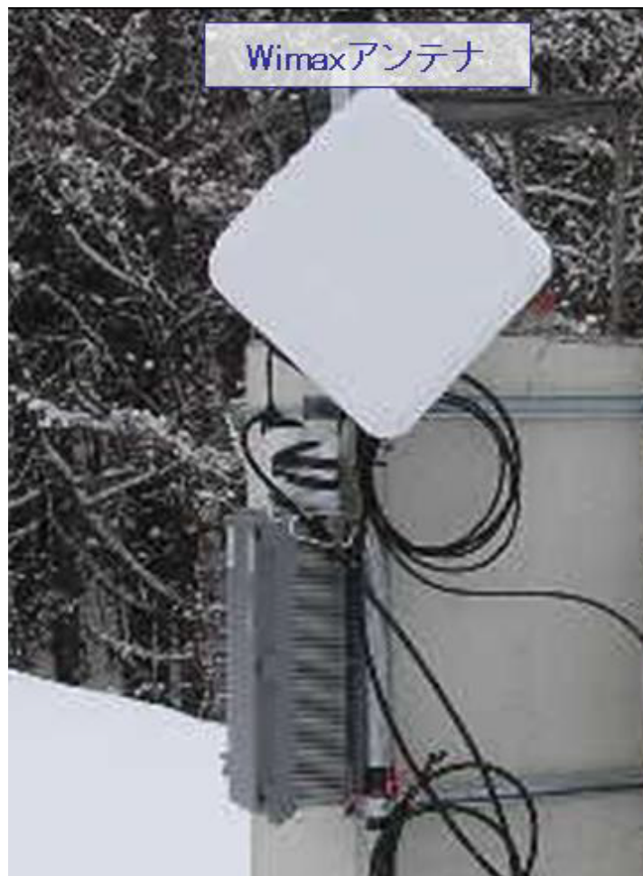
屋外設備(屋上)
