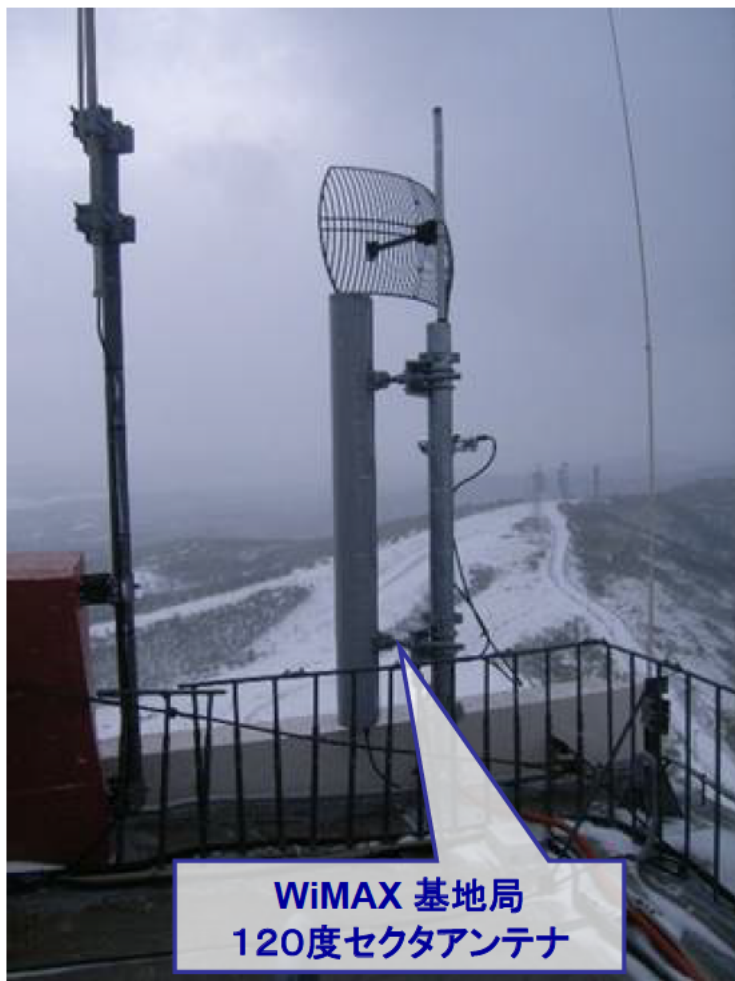
屋外設備(屋上)
