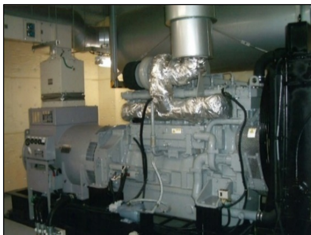
非常用発電機
