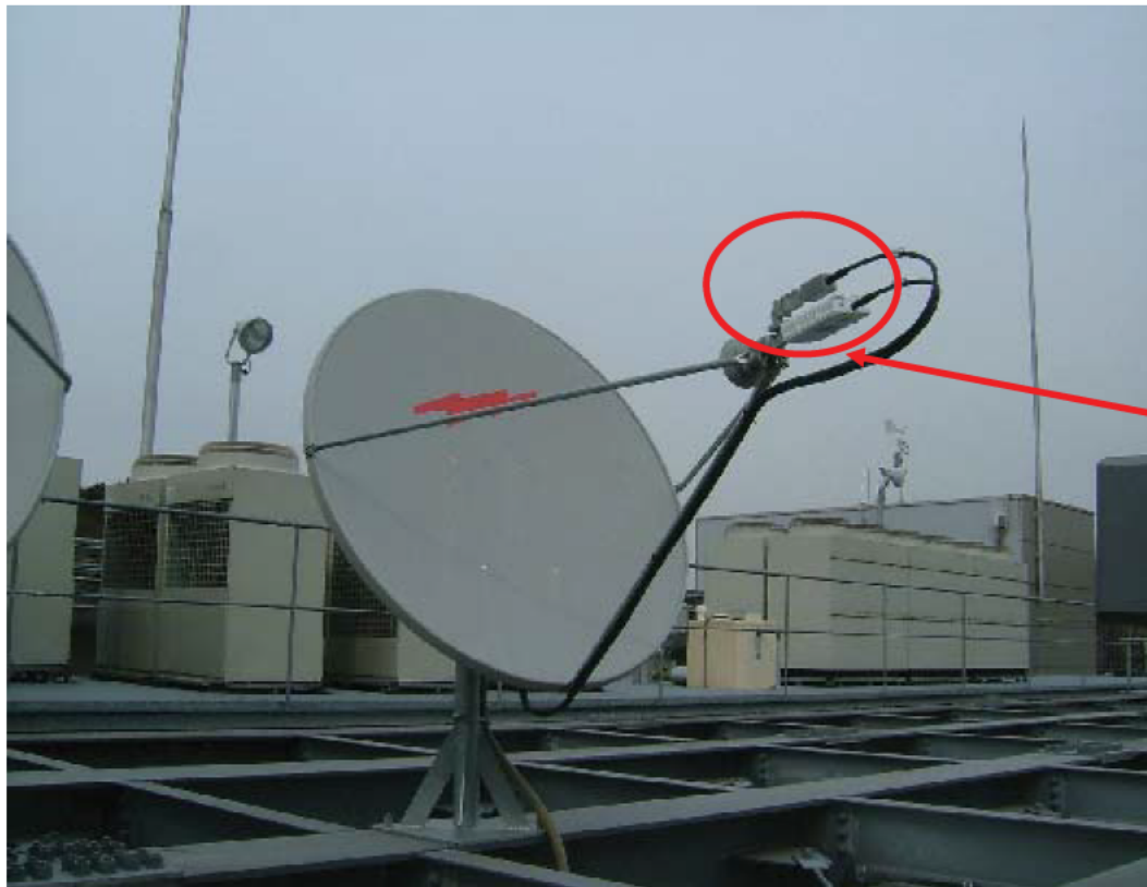
1.2mアンテナVSAT局
