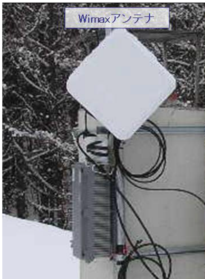
屋外設備(屋上)
