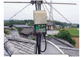
経年劣化したブースター
