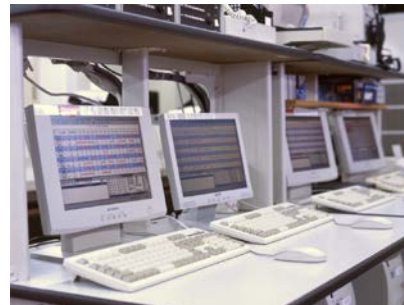
運用監視装置
