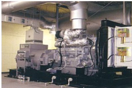
非常用発電機
