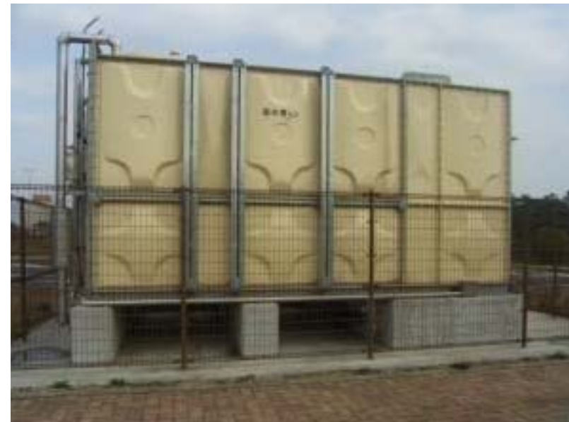
(飲料水貯水槽)
